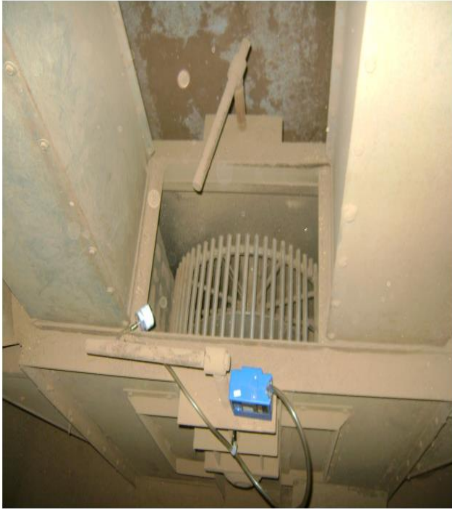
Figura 72: Local de instalação dos equipamentos de medição no elevador de transporte
