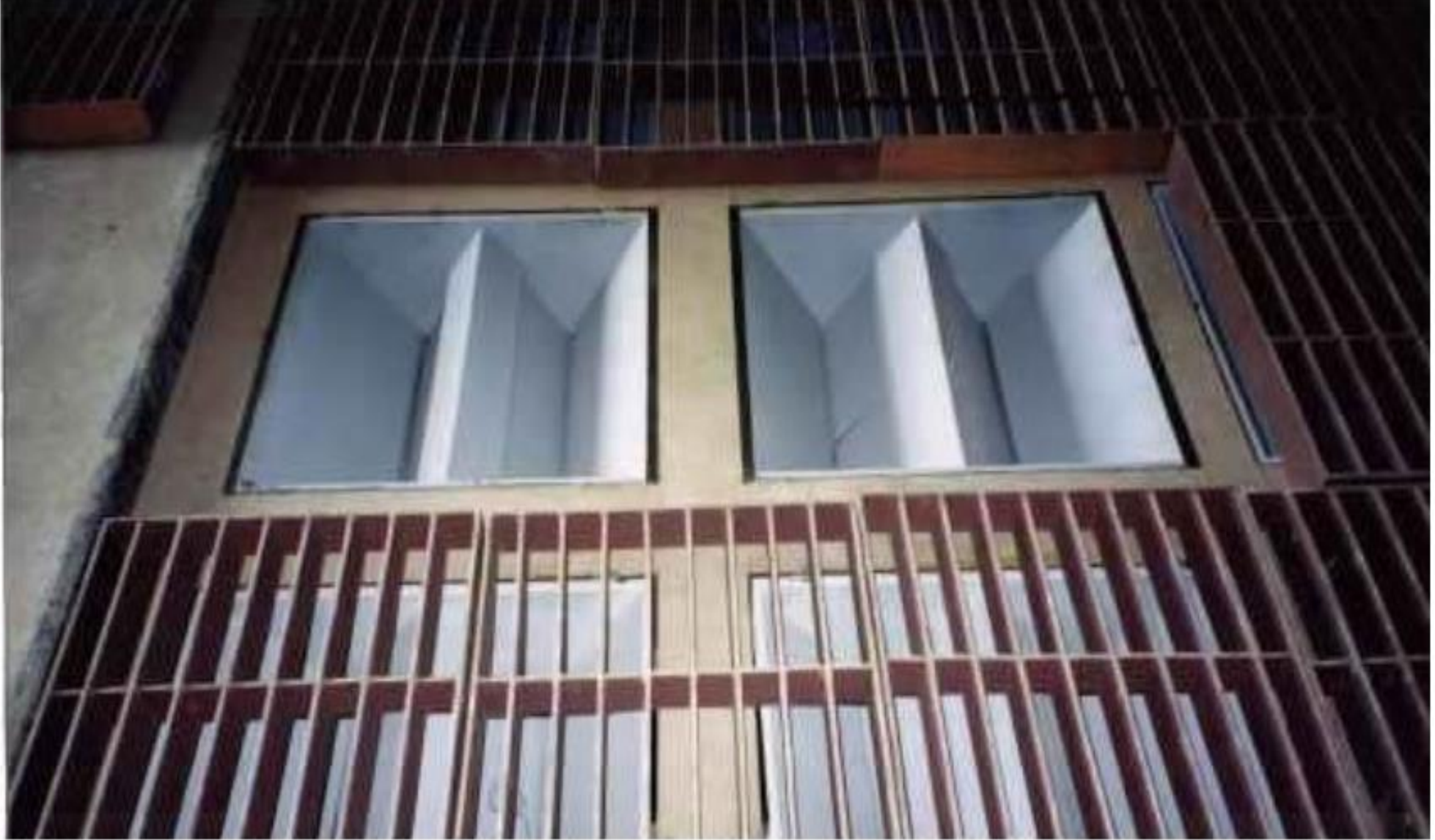
Figura 17: Sistema de captação de pó para moegas de descarga de caminhões / vagões com aplicação de abafadores de pó sob a grade
