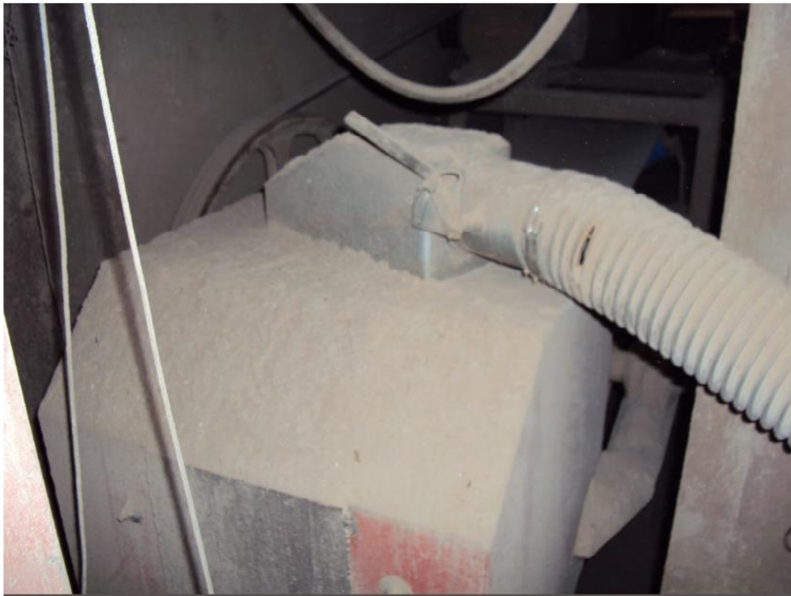
Figura 6: Poeira depositada sob acionamento da correia transportadora no túnel subterrâneo de uma unidade armazenadora de grãos
