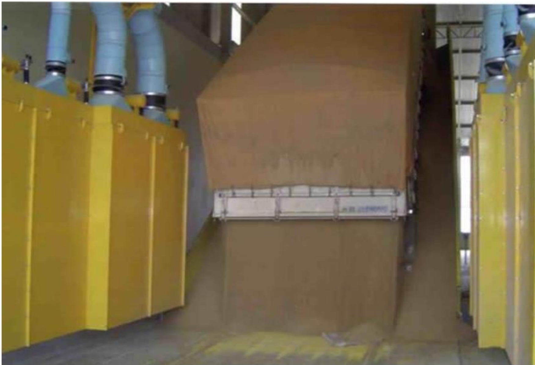
Figura 16: Sistema de captação de pó para moegas de descarga de caminhões / vagões com aplicação de abafadores de pó sob a grade
