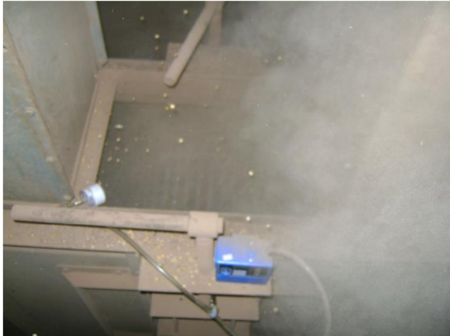
Figura 73: Medição no início do acionamento do elevador
